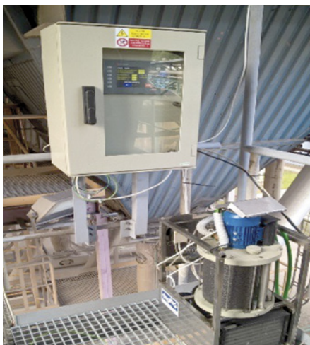
Automatické měření rosného bodu spalin
