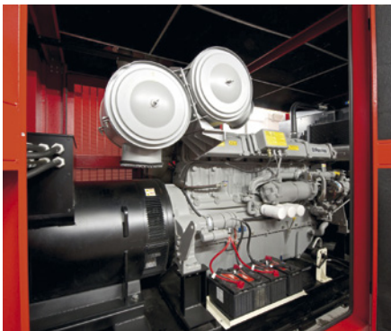
Lodní motor (1000 kW) sloužící jako záložní zdroj napájení datového centra. Motor spotřebuje 220l nafty za hodinu.
