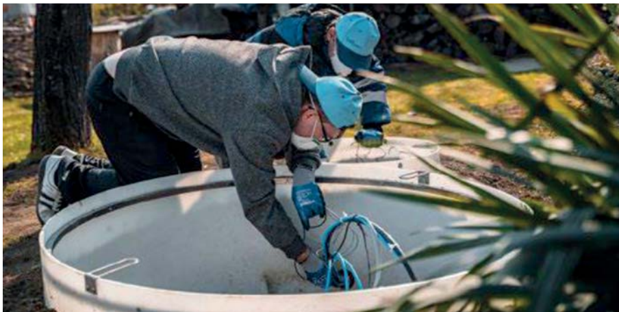
Instalace telemetrie do domovní ČOV
